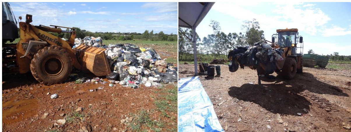
Figura 5 – Montante de resíduos descarregado pelo caminhão coletor e operação do trator retroescavadeira, homogeneizando os resíduos.
